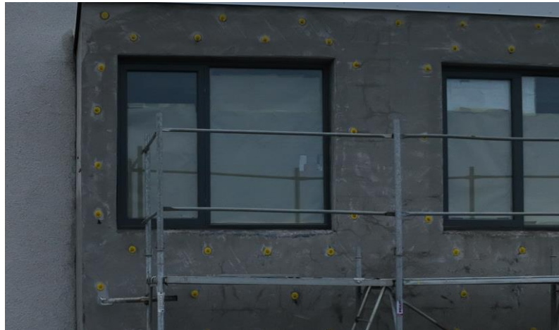
Mynd 3 – Slæm vinnubrögð Verktaka 1 á vegg N5 á Norðurbyggingu.
