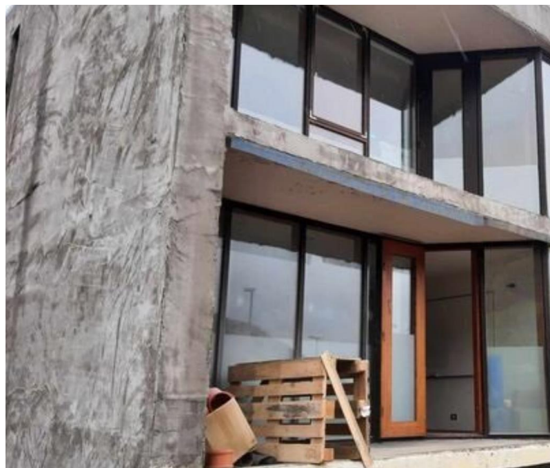
Mynd 4 – Slæm vinnubrögð Verktaka 1 á vegg N5 á Norðurbyggingu
